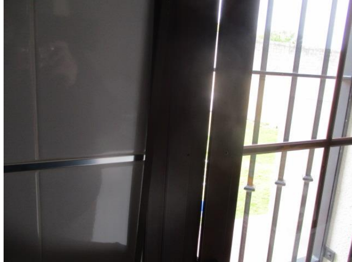
Puerta terraza afectada.
