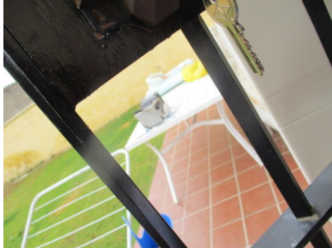
Daños en cerraduras.
